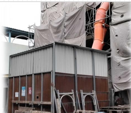
密閉輸送管道
